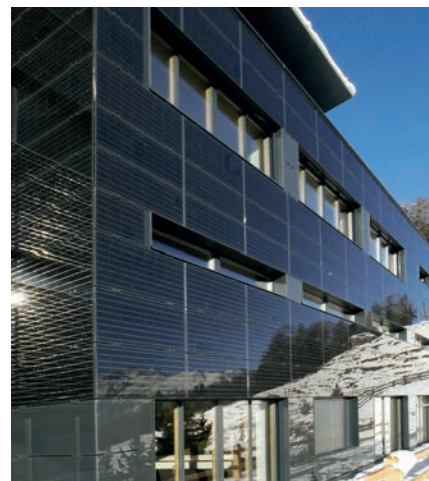
PV-Module in St. Moritz. Fassade, Fenster und Module sind eine gestalterische Einheit und spiegeln den Ortsraum.
