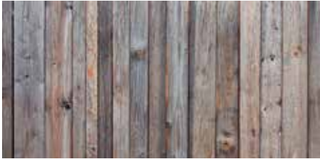
Wetterexponierte Holzfassade mit vergrauter Oberfläche
